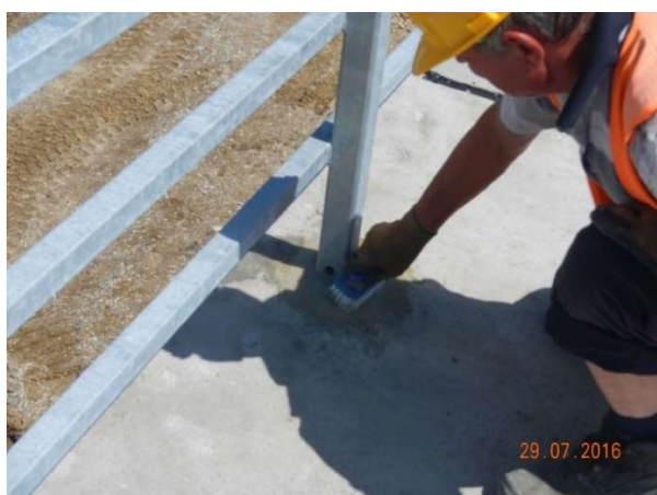
Detalj izljevne rupe kondenzata
