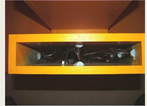
Tlakomjeri instalirani u keson segmenta dugih kolona (P12 – P20)
