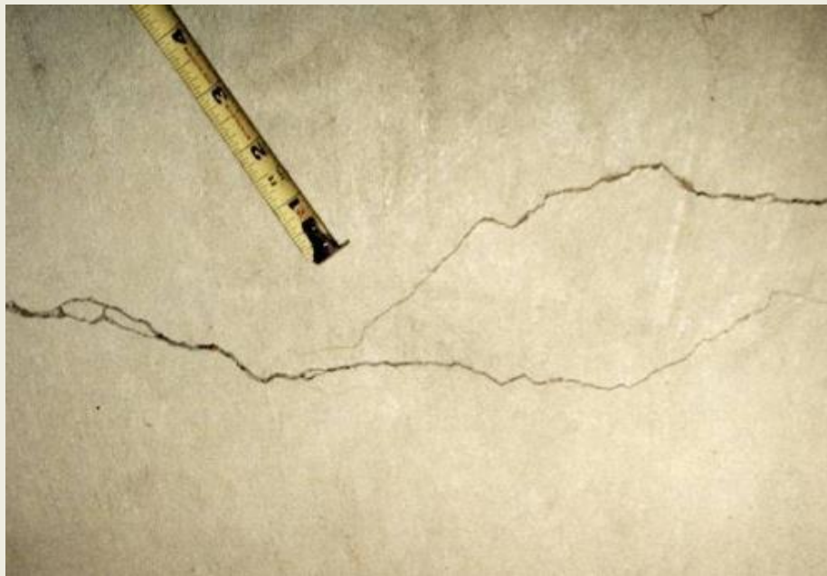
Slika 9 – Lom betonske nosive ploče uslijed premale projektne nosivosti
