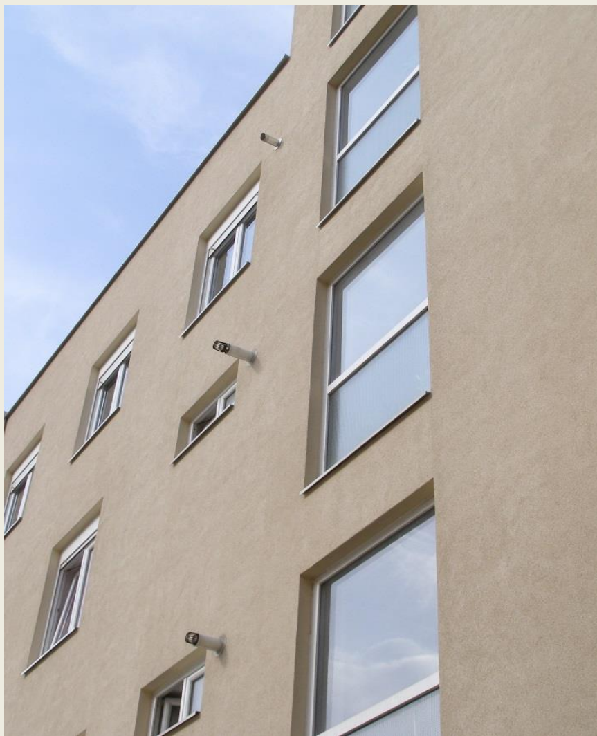
Slika 4 – Neispravni fasadni ispusti plinskih trošila
