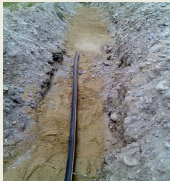
Slika 7 – Neispravan rov plinovoda
